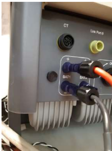
Rysunek 130 - Podłączenia mocy prądu stałego po stronie falownika wyłącznie z jednym wejściem baterii
