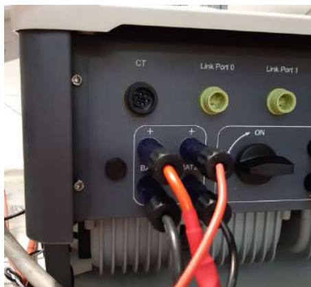
Rysunek 64 - Podłączenie mocy prądu stałego po stronie falownika z dwoma wejściami baterii
