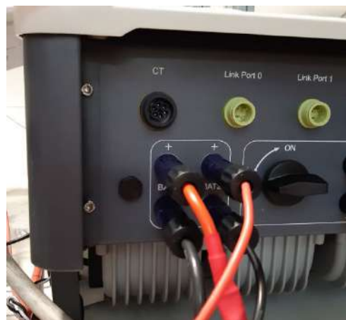
Rysunek 78 - Podłączenie mocy prądu stałego po stronie falownika z podwójnym wejściem baterii
