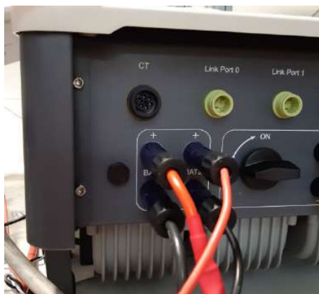
Rysunek 56 - Podłączenie mocy prądu stałego po stronie falownika z dwoma wejściami baterii
