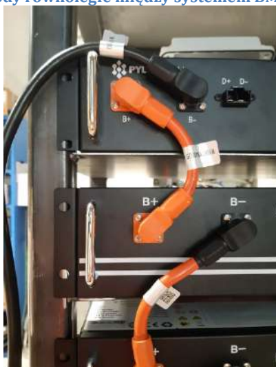
Rysunek 44 - Podłączenie zasilania (dodatnie) pomiędzy BMS a pierwszym modułem baterii
