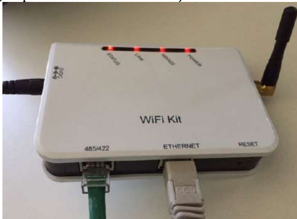
Rysunek 227 - Przewód ethernet podłączony do rejestratora danych
